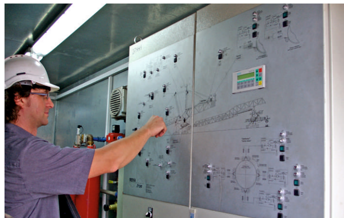
Блок управления секционной системой
