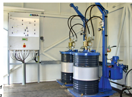
Насосная станция с бочковыми насосами и блоком управления
